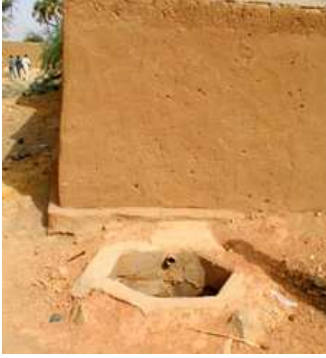
Photo 2 : Puisard à Niamey au Niger (pS-Eau, 2003)
